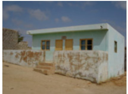
Jardin d'enfants nécessitant réfection (Dom João)
